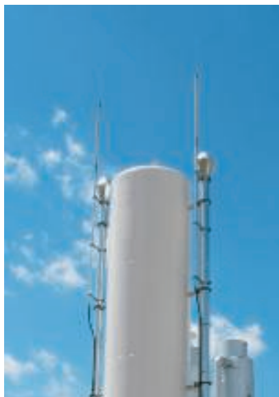
Sustav isCon® u području ispusta bioplinskog postrojenja
