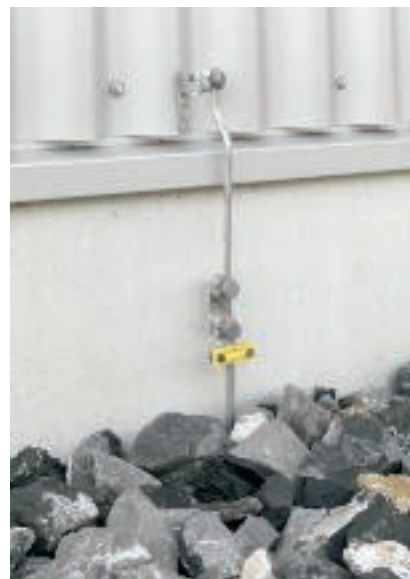
Mjerni spoj na sustavu za uzemljenje
