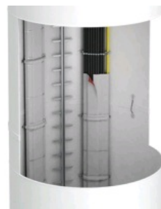
Slika 23: Bandažirana kabelska trasa u stupu vjetroelektrane
