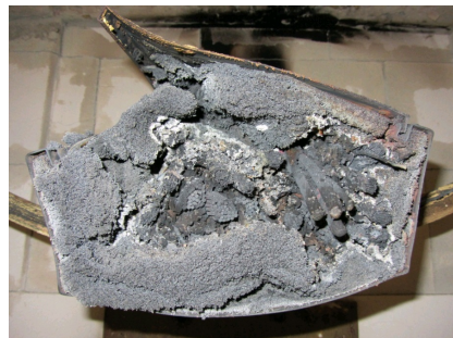
Slika 10: Presjek kanal Pyroline Rapid nakon požara u kanalu
