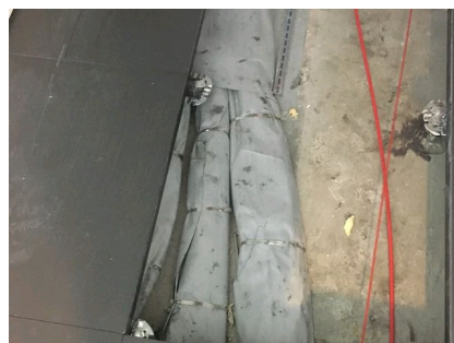
Slika 31: Bandažirana instalacija u podignutom podu.
