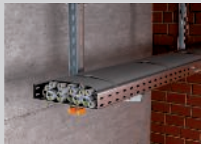
Omatanje snopova kabela na sustavima nosača kabela.
