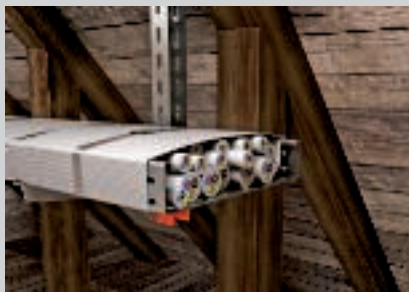
Bandažirani sustavi nosača kabela u područjima s puno gorivih materijala.
