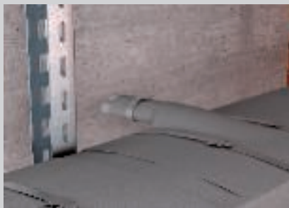
Kabelski izlaz omotan bandažom.
