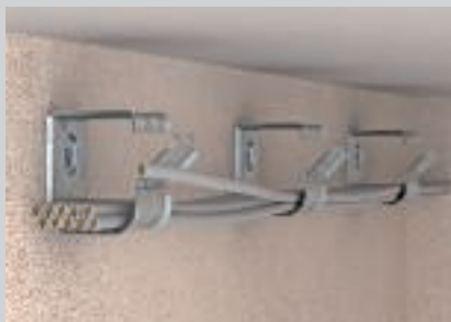
Jednostavno polaganje kabela u otvorenu obujmicu.
