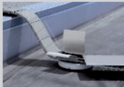
Primjena kod fotonaponskih kabela provedenih preko požarnog zida.
